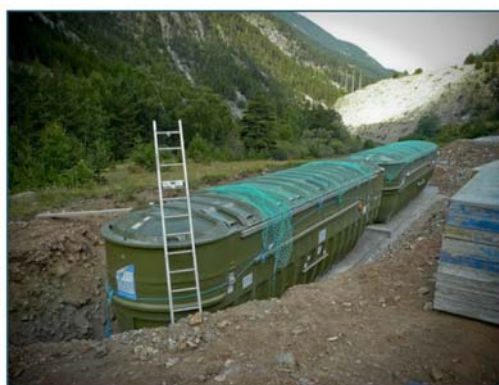
Les cuves de la STEP
