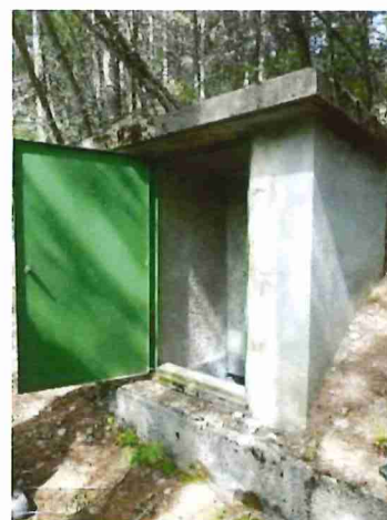
Captage du Bessey
