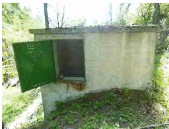
◆Captage de Rocher Blanc
