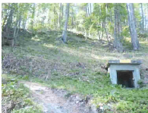
◆ Captage de Gratar
